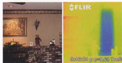
断熱材不足による壁面温度の低下箇所を発見!
