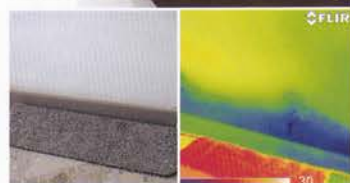
浸水による壁面下部の温度低下部分を確認!
